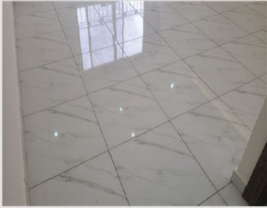
صورة #4: اعمال البلاط مثبتة بشكل جيد
