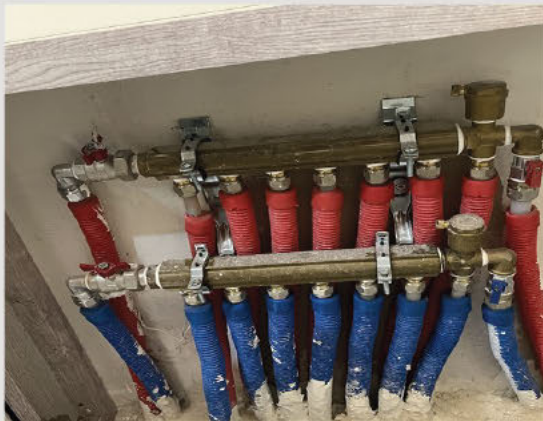
صورة #6: خزانة مياه التدفئة جيدة التنفيذ
