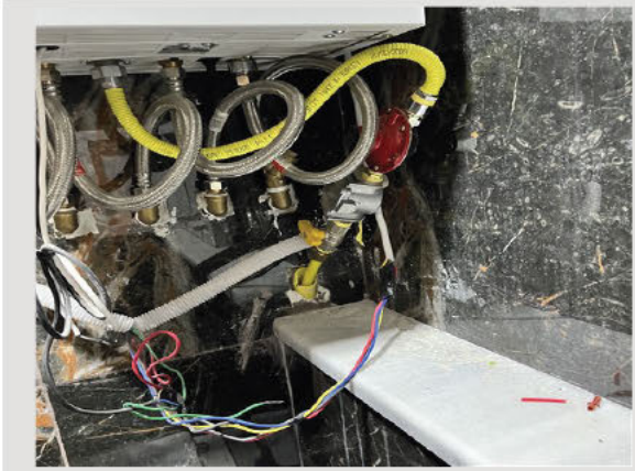
صورة #6: يجب إعادة ترتيب تمديدات البويلر
