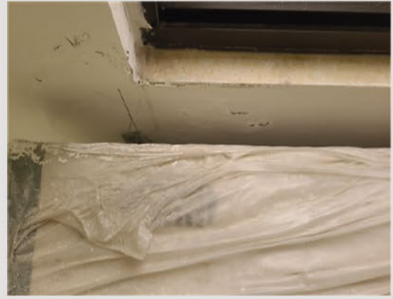
صورة #1: رطوبة اسفل الشباك
