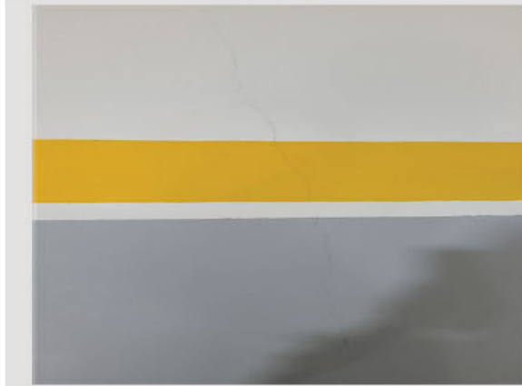
صورة 1# : بسبب هبوط طبيعي في اساسات المبنى
