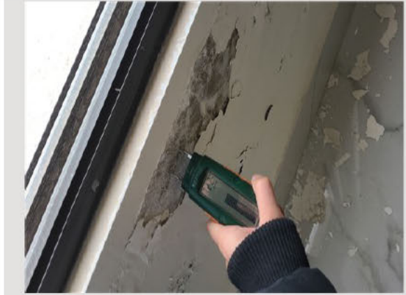
صورة #1: رطوبة مرتفعة اسفل الشباك
