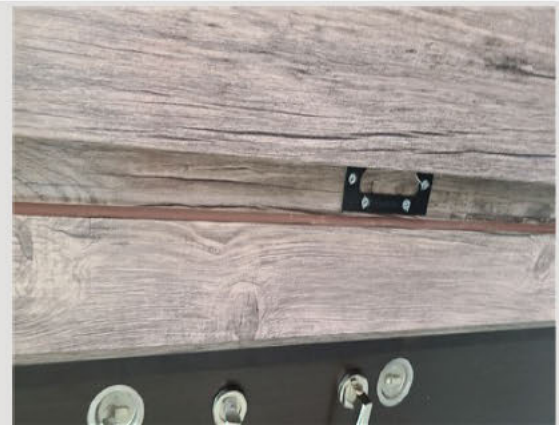
صورة #5: وجود مطاط لعزل الصوت
