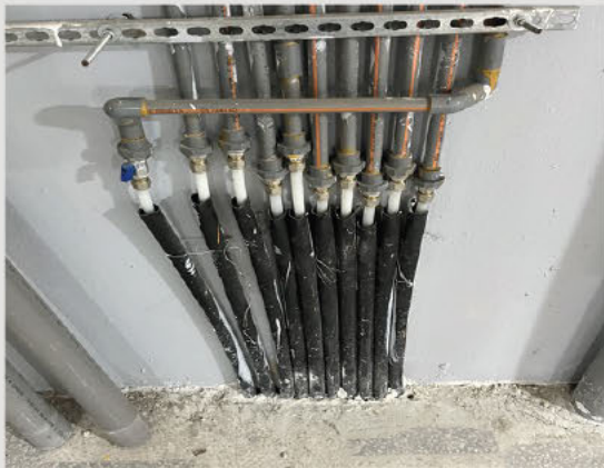
صورة #6: انابيب المياه المكشوفة مدككة
