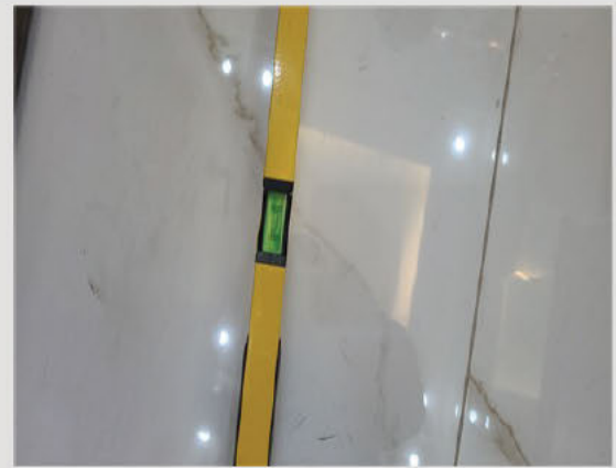
صورة #1: عدم كفاءة الميول بارضيات الحمامات
