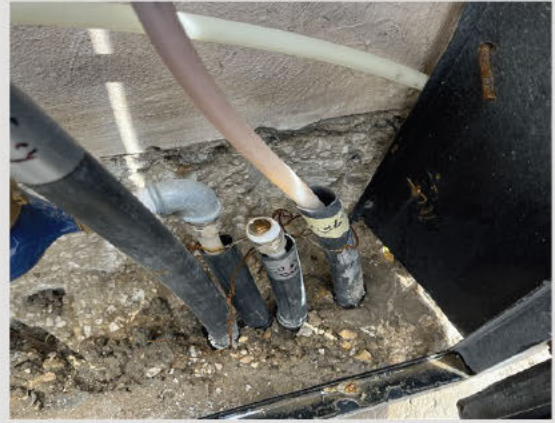
صورة #3: تمديدات انابيب المياه مدككة
