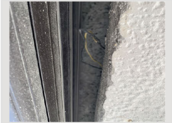
صورة #2: لم يتم إكمال أعمال الإنارة
