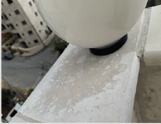
صورة #2: تسرب المياه من علب الكهرباء
